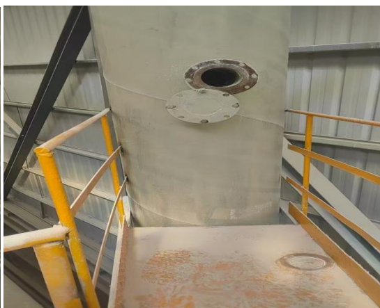
采样口及采样平台
