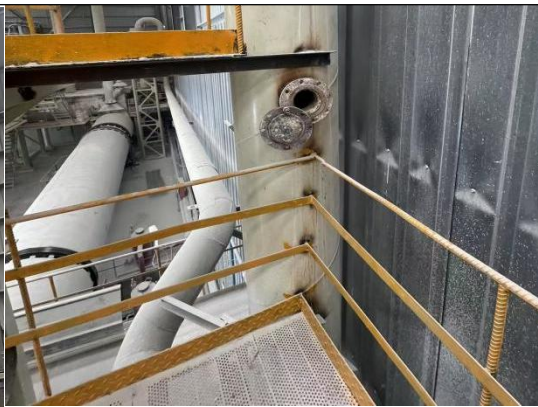
采样口及采样平台
